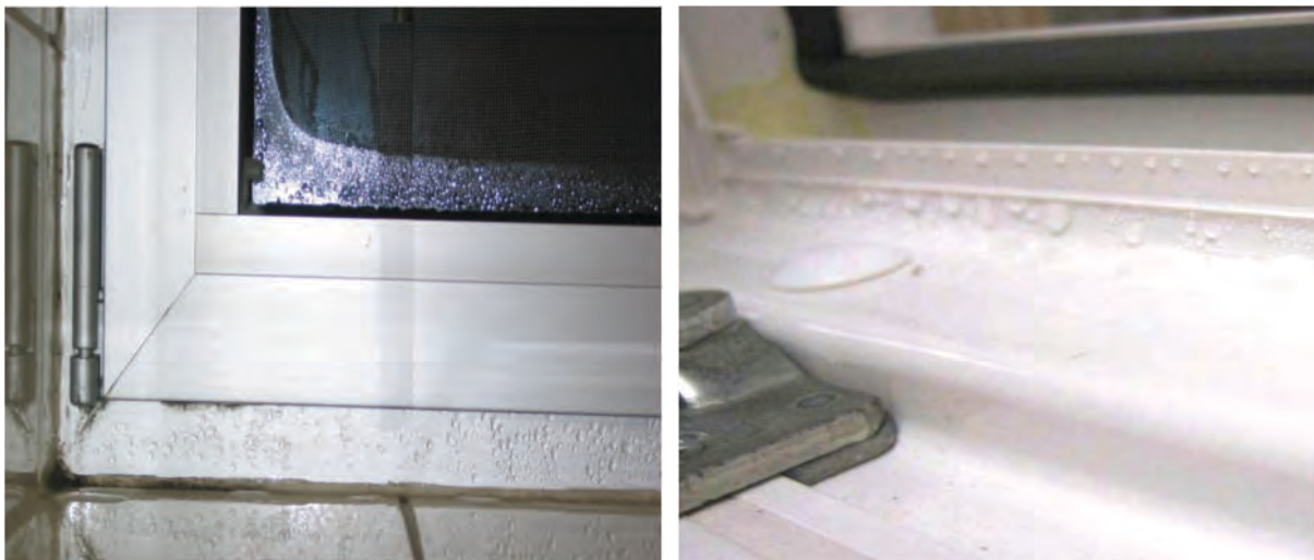
Bild 1.1 links Kondensatbildung an der Isolierverglasung und auf Blend- und Flügelrahmen sowie rechts in der Funktionsfuge eines Fensters
