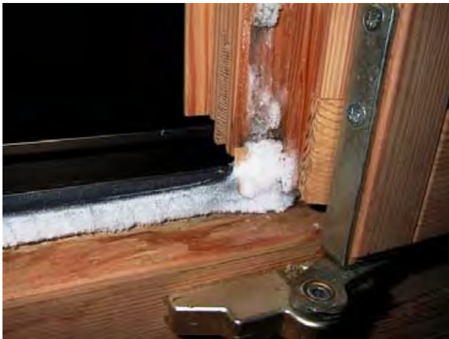
Bild 2.3 Beispiel für Kondensatklasse 4 E mit deutlicher Eisbildung an der Mitteldichtung
