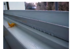
Bild 12.6 Kondensat im Funktionsfalz
