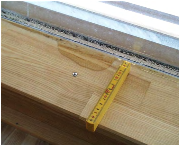
Bild 2.2 Abrinnendes Kondensat an einer Festverglasung, Am Silikon der Nassabdichtung ist bereits Schimmelwachstum an Verschmutzungen erkennbar.
