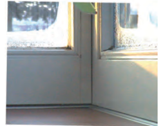
Bild 5.4 Kondensatbildung an Fenstertürelementen in einer exponierten Ecksituation
