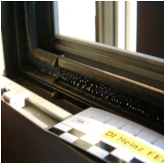
Bild 1.2 Kondensat im Funktionsfalz an der Mitteldichtung
