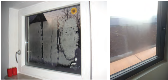
Bild 9.3 Kondensat- und Eisbildung an der Außenseite von hoch wärmedämmenden Verglasungen
